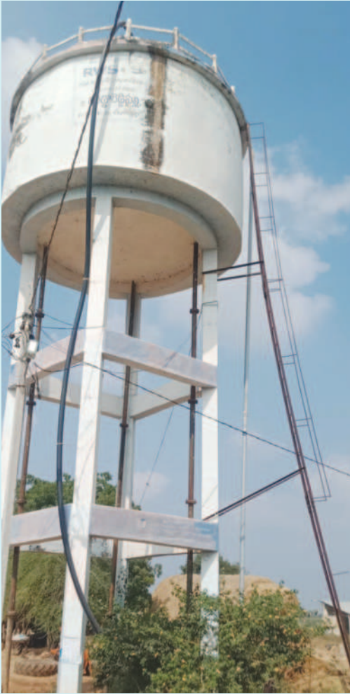
బుడ్డారెడ్డిపల్లె గ్రామంలో శుభ్రపరచని తాగునీటి ట్యాంక్, ట్యాంకుకు ఏర్పాటు చేసిన క్రింది భాగం నుంచి 15 ఫీట్ల దూరం తొలగిపోయిన ఇనుప మెట్లు
